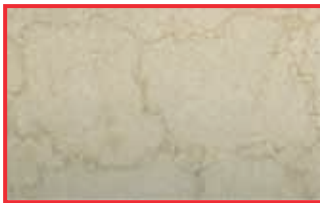
Fleckenmuster durch Verunreinigungen im Dampfcondensat
