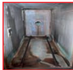
Links-Filterhalter mit partikulärem Korrosionsbefall Ursache: Starker Rostbefall der Sterilisierkammer führt zu Flug-/Folgerostschäden
